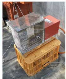
炭酸ガス発生装置 (プロパンガス燃烧方式)
