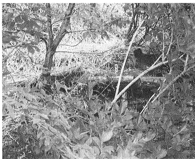
法面上段の倒壊した柵工と倒壊しなかった下段の柵工
