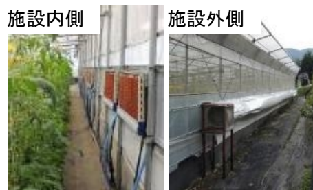
図6 ハウスのサイドに設置した例
